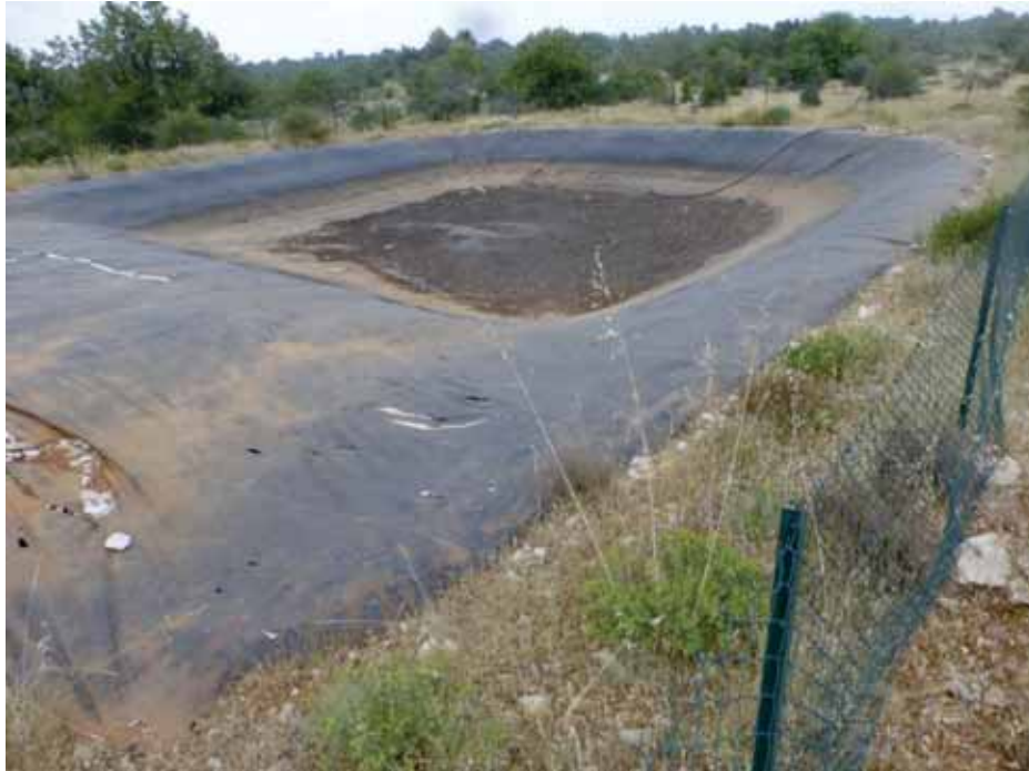
Le bassin-impluvium hors d'usage du fait des très nombreux trous dans la bâche EPDM
