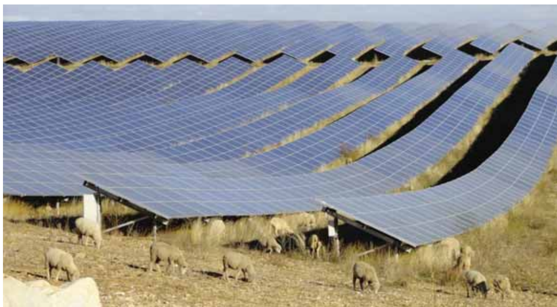
Pâturage dans un Parc Photovoltaïque sur la commune des Mées (source Chambre d'Agriculture 04)
